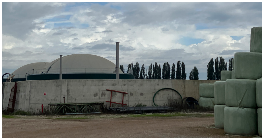
L'impianto di digestione anaerobica, utilizzato per il trattamento dei reflui
